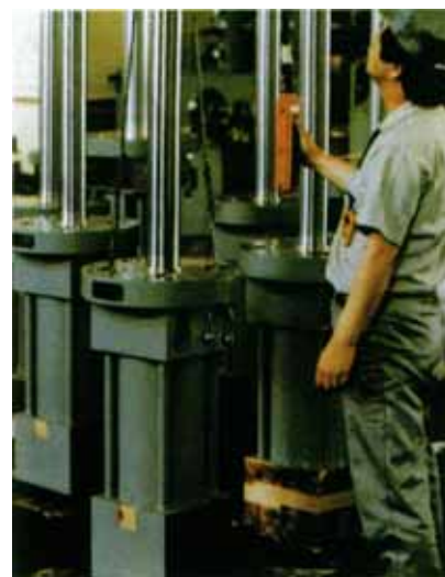
Гидроцилиндры привода системы клапанов парогенератора на АЭС
